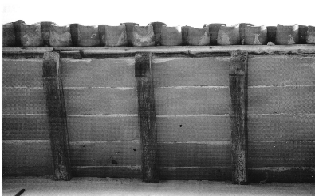
Particolare del sottotetto con i fori dei proiettili esplosi prima di partire per la Russia
